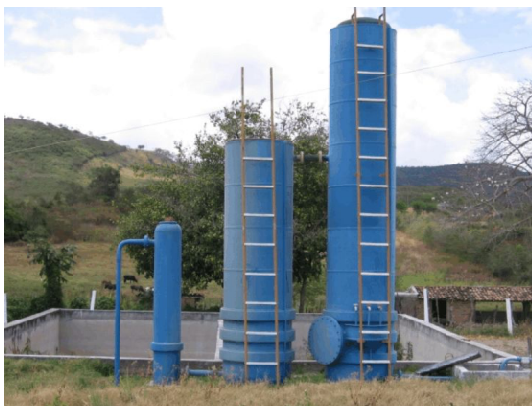
Figura 7.2 Estação de tratamento de esgoto (ETE-MUTUCA)
