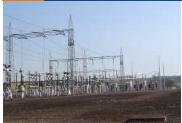
FIGURA 2.5 Subestação Londrina - PR
