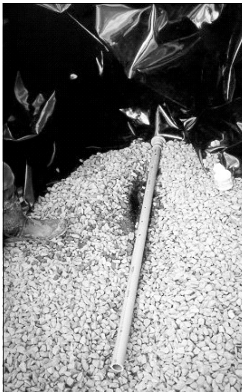
Figura 3.6 Tubulação perfurada entre a brita para coleta do lixiviado.
