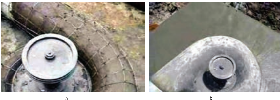
Figura 2.18 – Construção da caixa espiral pelo método “argila-perdida”: (a) molde em barro com armadura de ferro; (b) turbina com a caixa espiral já concretada.
