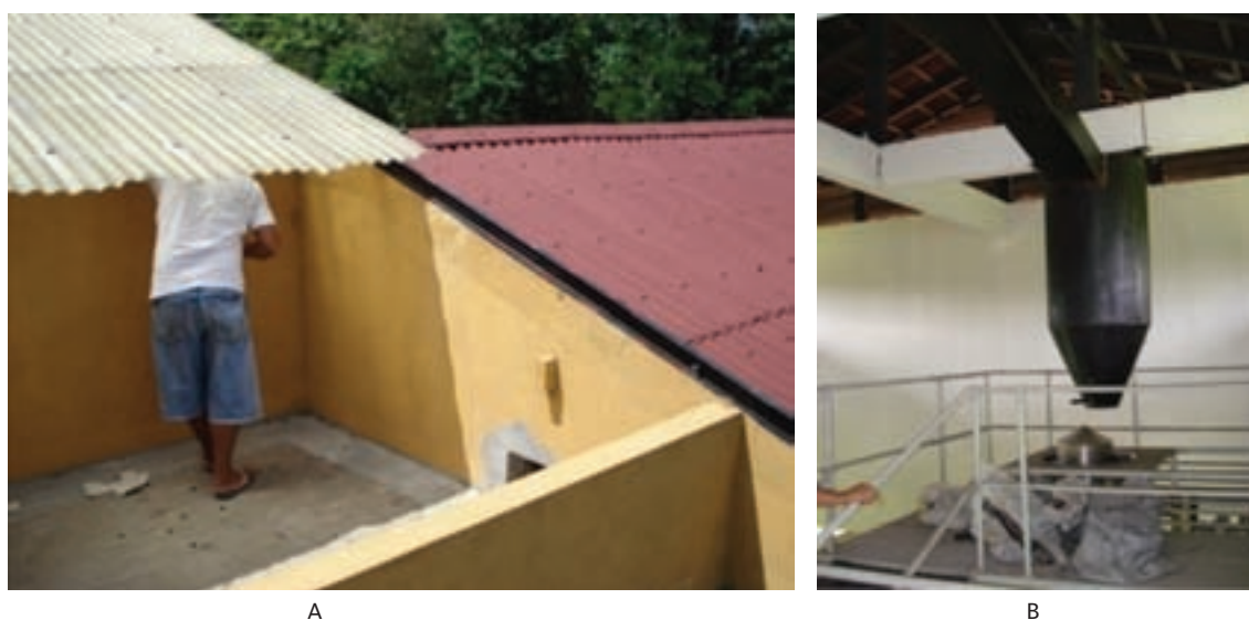
Figura 3.12 – A: Depósito de secagem de biomassa, com cobertura móvel para proteger da chuva; B: Duto de ligação do silo com o gasificador
