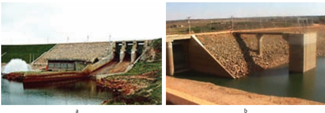
Figura 2.24 – Barragem de enrocamento – PCH Machado Mineiro: (a) vista de jusante; (b) vista de montante
