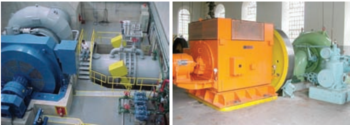
Figura 2.5 – Grupo Gerador: (a) PCH Alto Jaurú: a excitatriz, o gerador, a caixa espiral da turbina e a válvula borboleta; (b) PCH Luiz Dias, a excitatriz, o gerador, o volante de inércia, o regulador de velocidade óleo hidráulico e a caixa espiral da turbina hidráulica.
