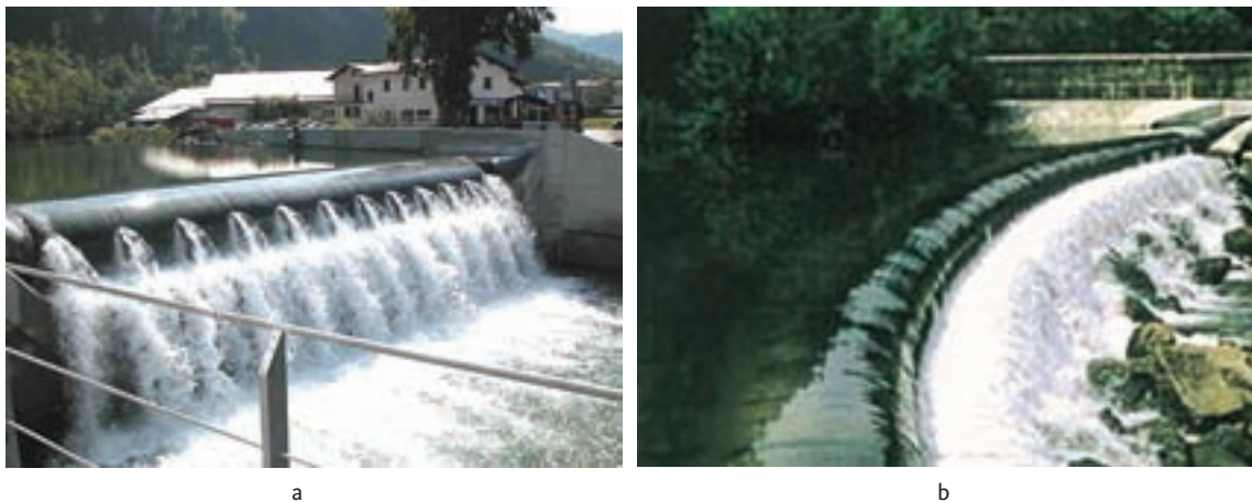
Figura 2.26 – Barragem de borracha inflável – fabricante Bridgestone: (a) instalada sobre um vertedor; (b) instalada sobre o leito de um curso d’água
