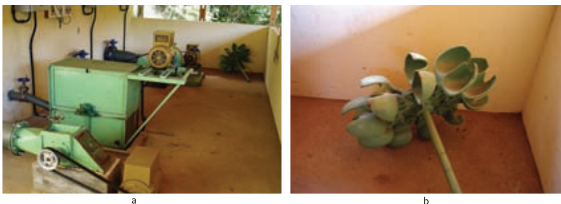
Figura 2.12 – Roda Pelton: (a) Grupo gerador com roda Pelton, fabricação Alterima (no primeiro plano vê-se um grupo gerador com turbina Michell-Banki – Unifei); (b) roda Pelton.
